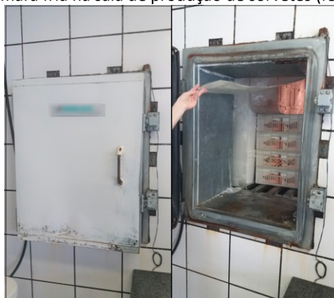
Figura 3 - Janela da câmara fria na sala de produção de sorvetes (fechada e aberta)
