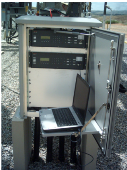
Figura 10 – Parametrização de relé “em campo”
