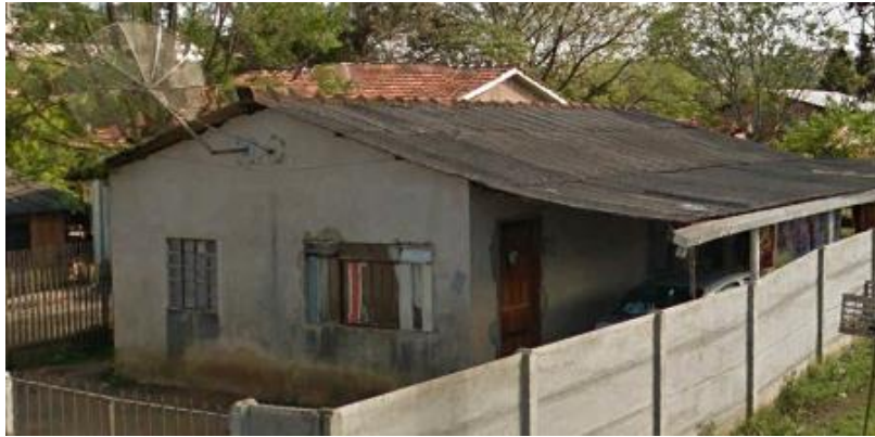
FIGURA 16 – Residência suscetível a destelhamento no Bairro Ronda.
