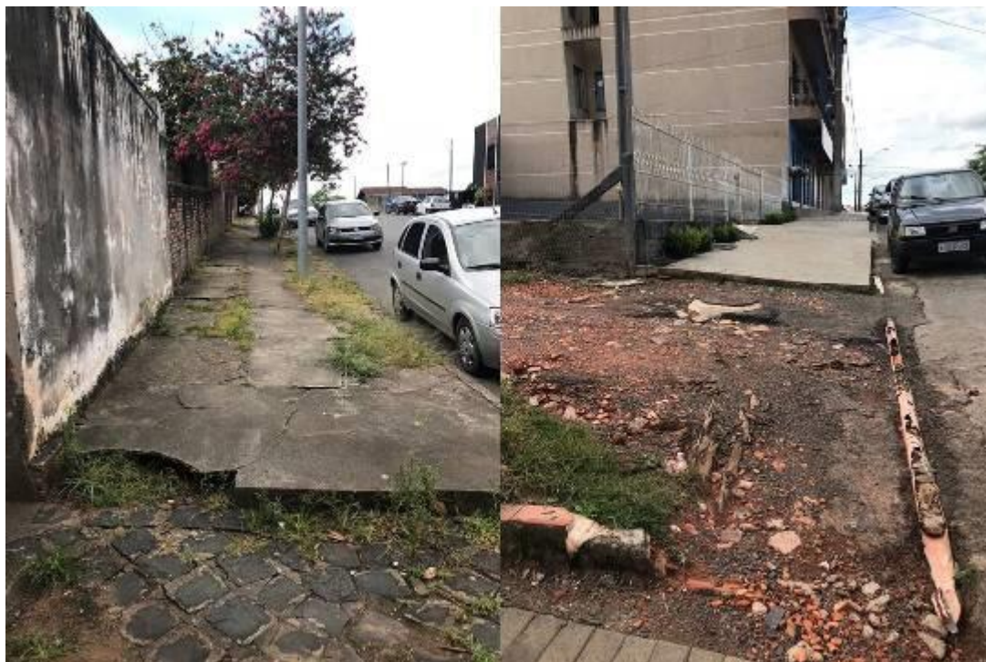
FIGURA 10 – Falta de manutenção das calçadas mais distantes da praça Cel. José Durski. Segmento de calçada S1.
