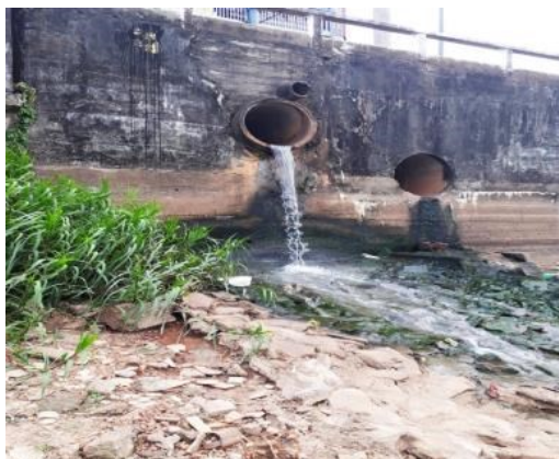
Figura 2 – Despejo de esgoto doméstico
