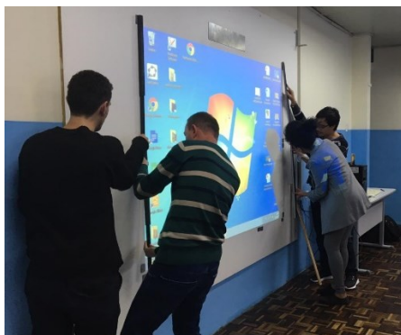
Figura 4 – Professores instalando a lousa
