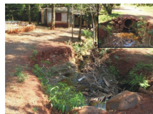
Figura 1 - Voçoroca no final da rua Alagoas. Marechal Cândido Rondon - PR
