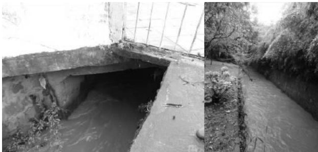
Figura 2: ponto de redução da seção, Bueiro 1.
