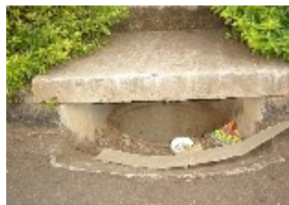
Figura 3: Bocas-de-lobo com fenda horizontal longitudinal sem grelha.
