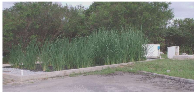
Figura 2 – Tanque de Tratamento de esgoto por zona de raízes na TPPF. Fonte: os autores
