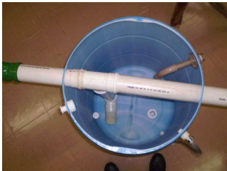
Figura 7: Sistema de entrada da água na cisterna.
