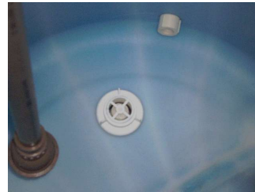
Figura 10: Ralo para limpeza da cisterna.
