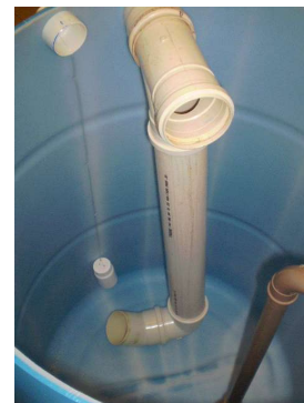
Figura 11: Sistema clorador para desinfecção da água armazenada.
